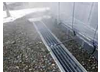
④熱交換後の温泉水は室外へ排出 し、周辺の融雪に利用
