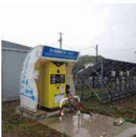
⑦EMS対応EV充電器
