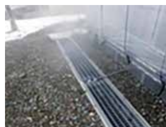
④熱交換後の温泉水は室外へ排出 し、周辺の融雪に利用
