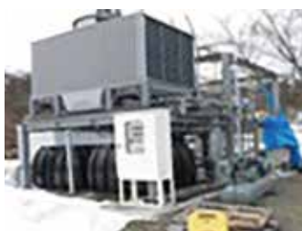
①小型バイナリー発電機設備 〈水/アンモニア混合熱媒体式 発電出力7.5kW（最大15kW）〉
